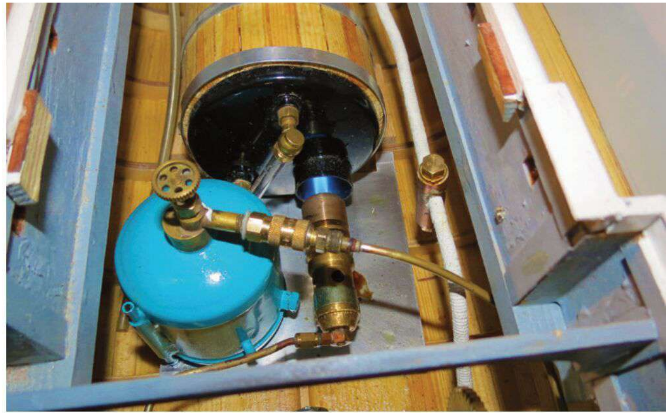
Brenner, Kesselfront und Gastank
