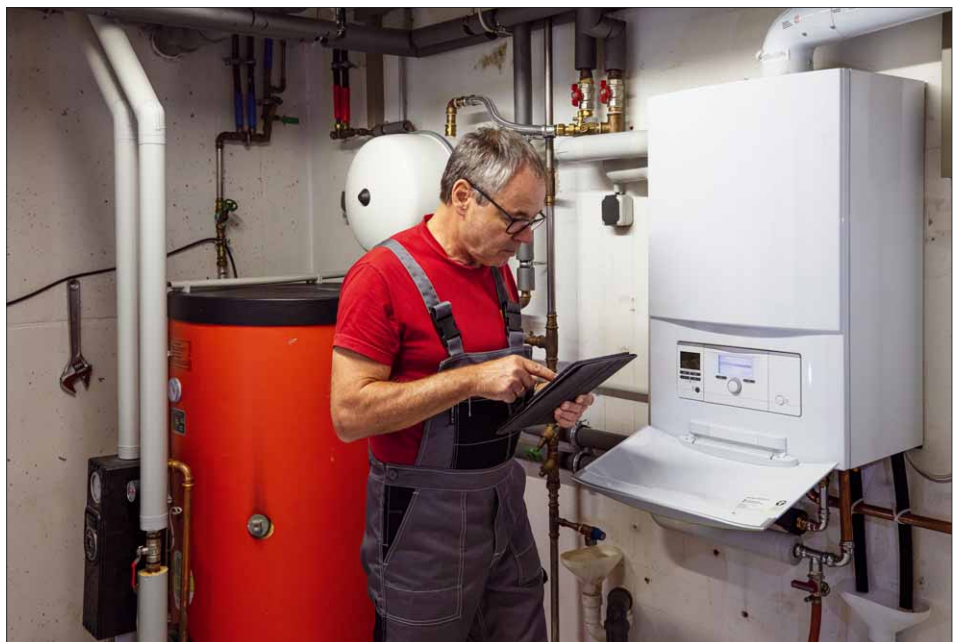
Die Wartung der Heizungsanlagen sollte durch qualifiziertes Personal erfolgen, um deren Funktion sicherzustellen
