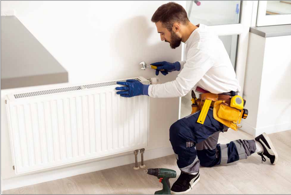
Dagegen können einfache Heizungsthermostate durch den Facility-Dienst getauscht werden
