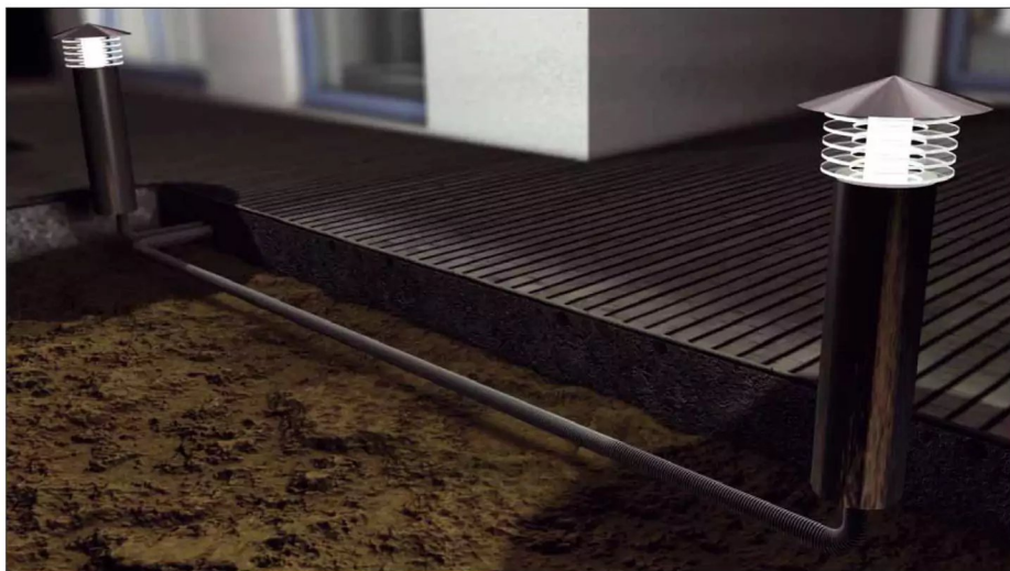
Die Verkabelung in Leerrohr ist sicher und sorgt für einfache Zugänglichkeit im Schadensfall
