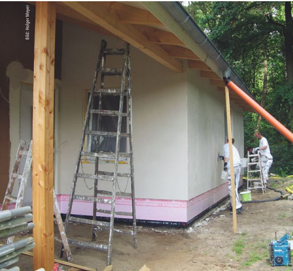
Die Putzbeschichtung ist beim WDVS der alleinige Witterungsschutz für die Holzkonstruktion. Die Dauerhaftigkeit muss in allen Details gegeben sein.
