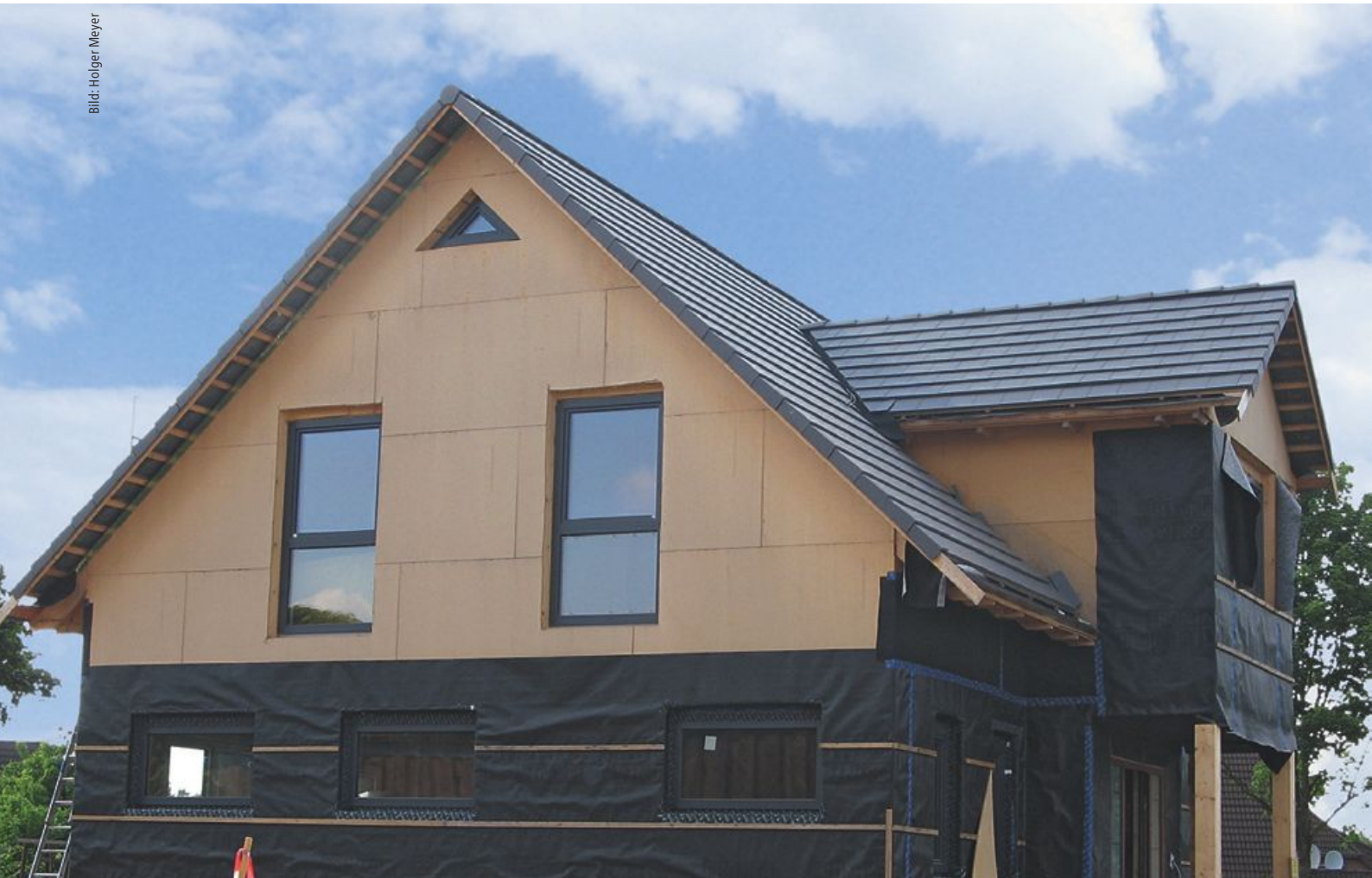
Bild 1: Bei diesem Objekt ist der Einbau der Fenster fast abgeschlossen. Welche Anschlussmittel von der Außenwand zum Fenster sind erforderlich? Und welches Gewerk ist für diese Anschlüsse zuständig?
