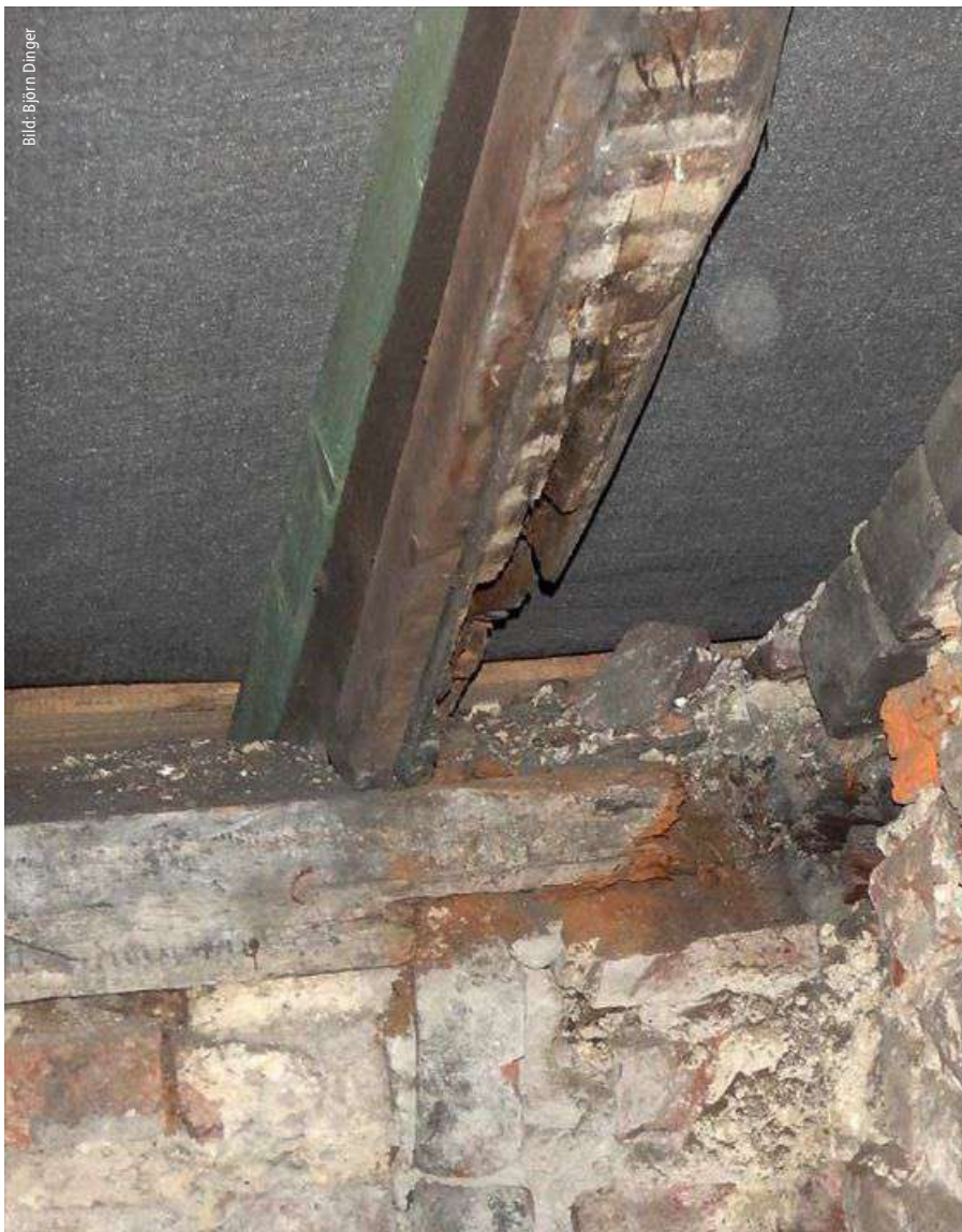
Bild 2: Durch Fäulnispilze geschädigter Sparrenfuß
