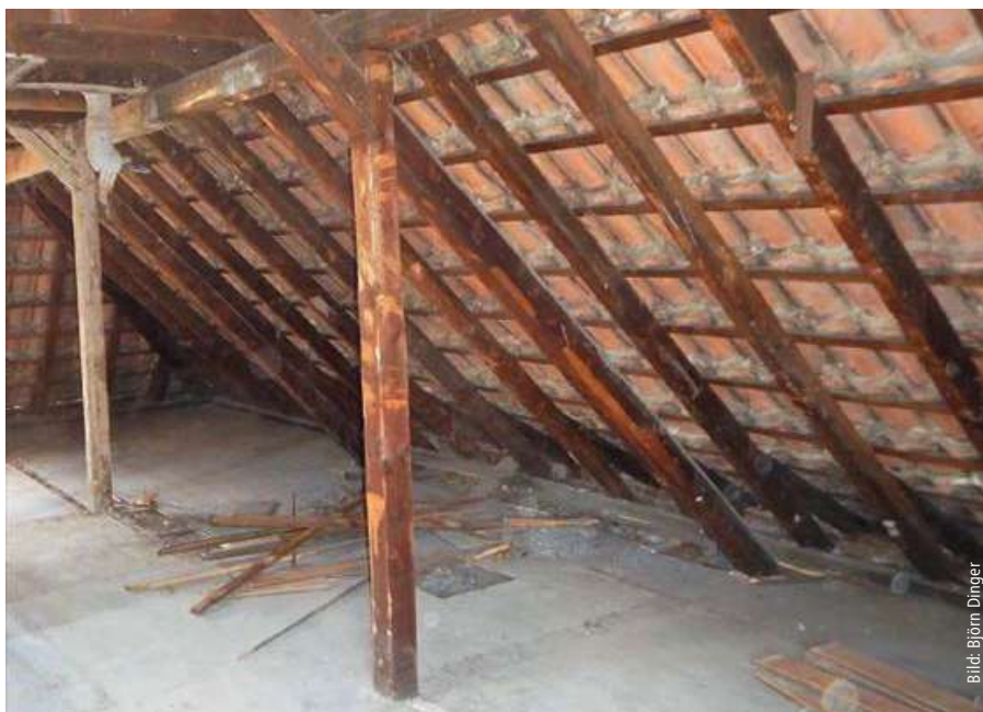
Bild 5: Angebeilte Sparren (helle Stellen), die auf eine Holzschutzuntersuchung hindeuten.
