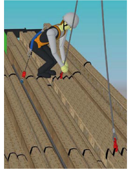
2 | Hier wurde der Auffanggurt über ein Höhensicherungsgerät an eine Schiene angeschlagen.
