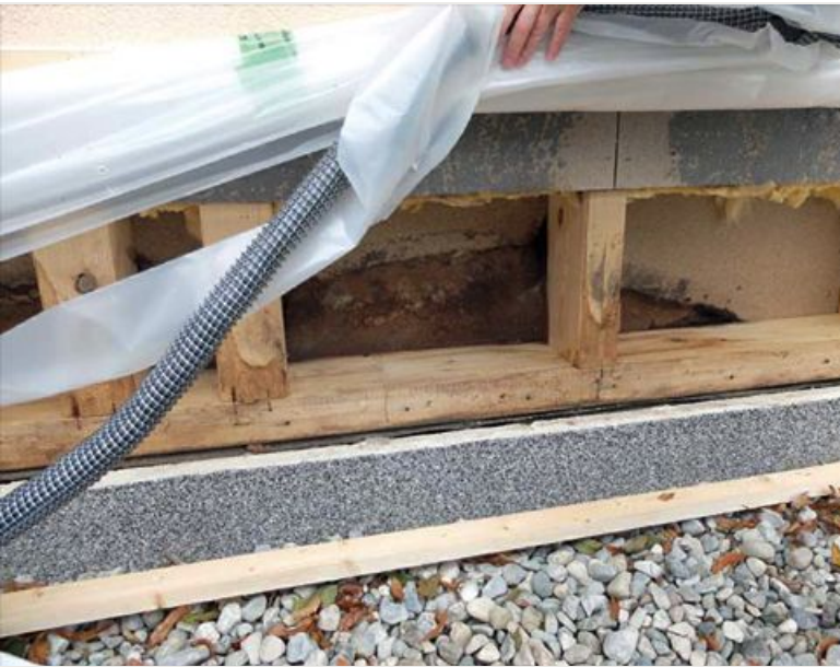
An der raumseitigen Spanplatte der Außenwand Nord zeigten sich Dunkelverfärbungen und Pilzansätze.
