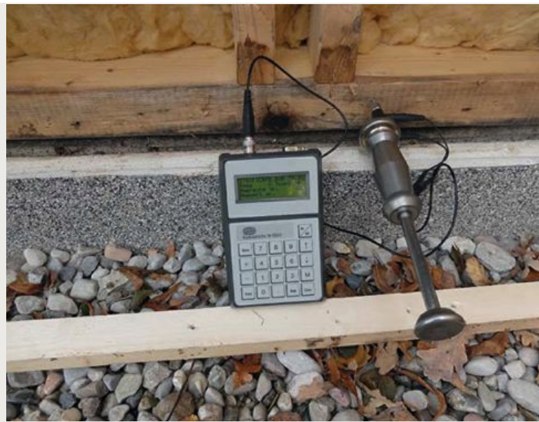
Nach etwa vier Wochen Trocknung betrug die Holzfeuchte an der Bodenschwelle der Holzriegelkonstruktion an der Außenwand Nord immer noch 30,5 %.
