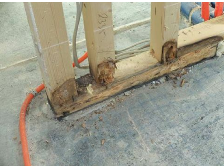
Eine Innenwand war im Fußbereich so stark geschädigt, dass Schwellenholz und Stiele bereichsweise ausgetauscht werden mussten.
