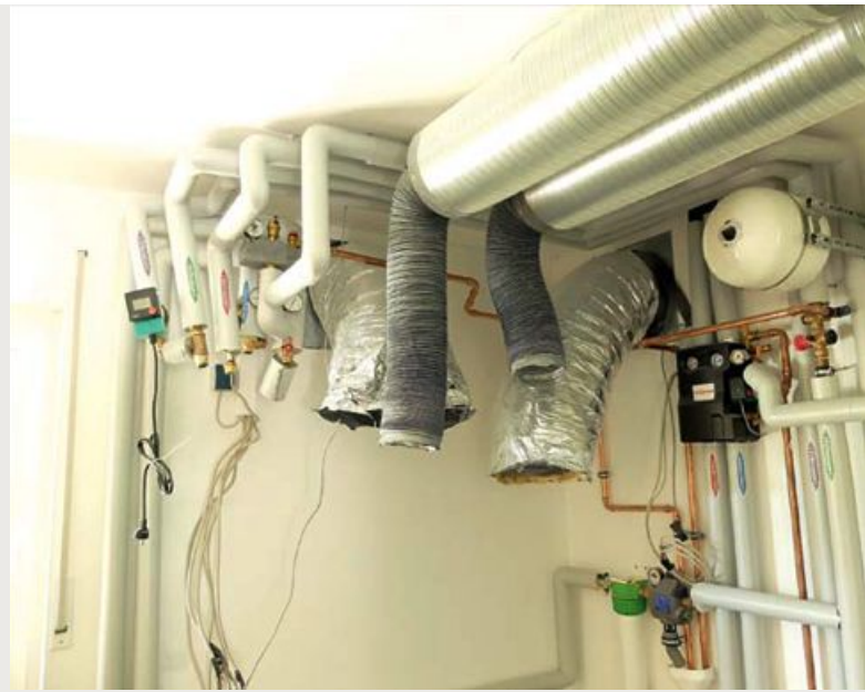
Für die Sanierung war es ebenfalls erforderlich, die Energiezentrale mit Wärmepumpe, Lüftungsanlage und Pufferspeicher im Erdgeschoss zu demonstrieren. In der Zeit hingen Rohre und Leitungen einfach von der Decke.
