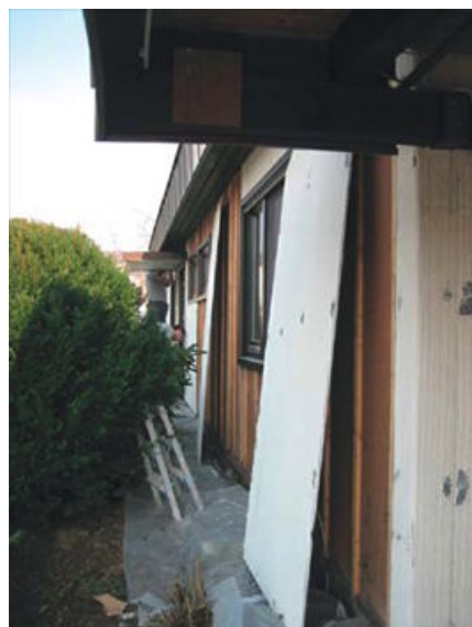
Die Demontage der vorhandenen Asbestzementplatten ist Pflicht. Einfach überdämmen ist nicht erlaubt und auch nicht zielführend.
