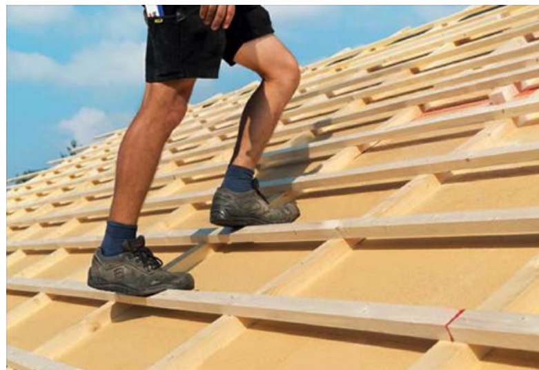
Die maschinelle Dachlattensortierung soll Durchtrittssicherheit und feste Standards garantieren.
