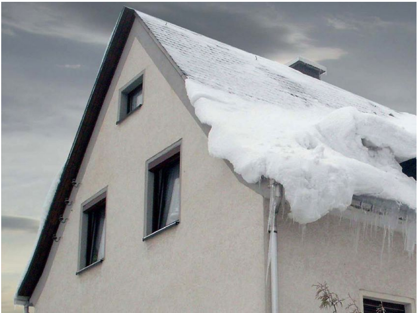
Ein Beispiel, wie es nicht sein soll: Schneemassen sammeln sich im Traufbereich und können, sobald die unterste Schneeschicht schmilzt, ungehindert auf den Verkehrsweg fallen.
