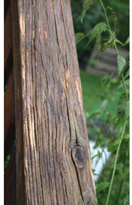
4 | Die Frühholzbereiche der direkt bewitterten Handläufe sind millimetertief ausgewaschen und weisen, bedingt durch klimatische Schwankungen, viele Risse auf.
