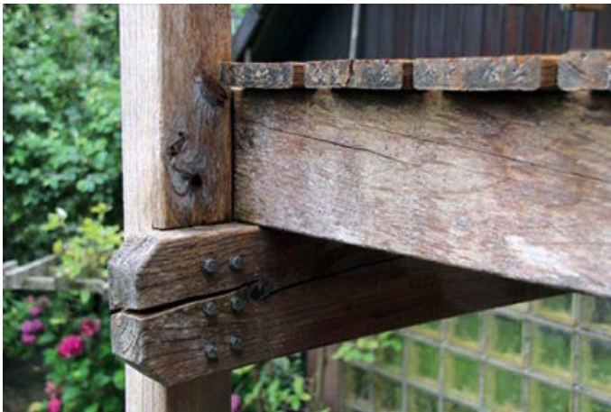
5 | Von den tragenden Teilen wies nur der Unterzug kopfseitige Schwindrisse auf.
