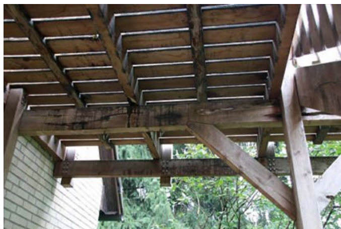
6 | Die Unterseite war unversehrt. Lediglich Verfärbungen durch ablaufenden Mooschlamms trübten die Ansicht.
