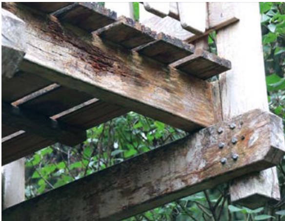
7 | Ein kurzer Träger mit sichtbarer Markröhre zeigt einen Ansatz von Fäulnis.
