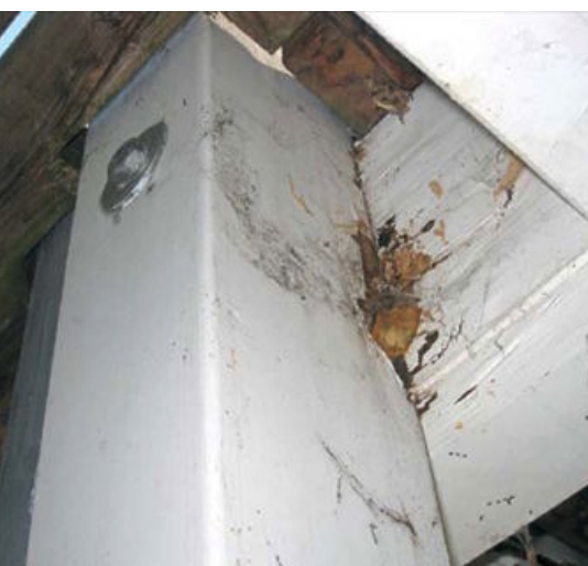
Auch dieser Holzknoten weist Fäulnis auf, weil der Abstand der Holzteile untereinander, der eine Luftumspülung zulassen würde, fehlt.
