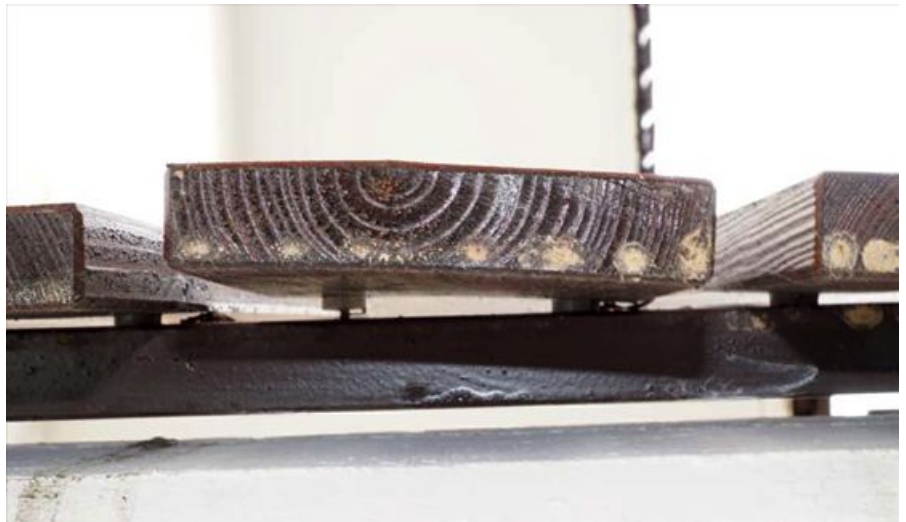
Auch bei dem Brett dieser Balkonbrüstung wurde ein Kernquerschnitt der Lärche verwendet, was eine starke Verformung infolge des Nachschwundes mit sich brachte, so dass die Schraubenbefestigung einseitig ausgerissen wurde. Auch hier hätte ein herzförmiger Querschnitt deutlich weniger Schwund und damit Verformungen verursacht.
