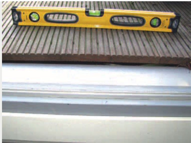
2 | Eine für die Nutzungsklasse nicht sachgerechte Holzfeuchte verursachte nach dem Einbau dieser Terrassendielen Wölbungen und eine Schließung der Fugen.
