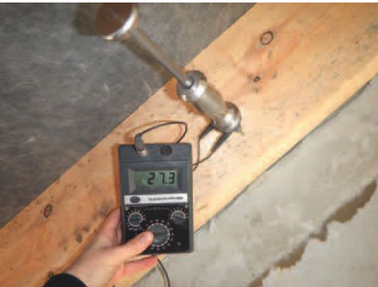
3 | Auch an diesem Dachstuhl schimmelte es kurze Zeit nach dem Einbau. Die Holzfeuchte war zu hoch.
