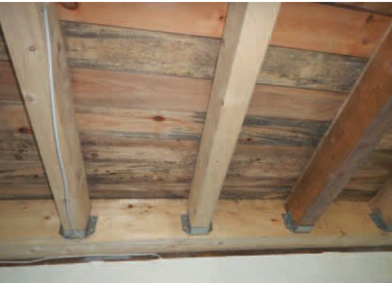
1 | Diese Dachschalung schimmelte nach dem Einbau. Eine Ursache war die zu hohe Einbaufeuchte.
