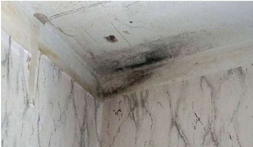
Auch der Schimmelpilz an der Deckenunterseite dieser Gebäudeaußenecke wurde durch Wärmebrückeneffekte hervorgerufen. Die Ursache ist eine auskragende Stahlbetondecke.
