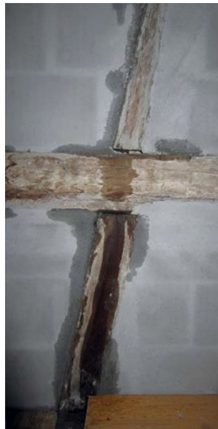
Werden die Anschlussfugen zwischen Riegelwerk und Gefach einer Fachwerkwand nicht nachgebessert, kann sich der Schlagregen durchdrücken.
