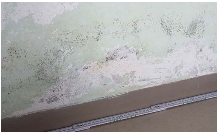
Im Sockelbereich zeigen sich an der Innenwand fleckige Verfärbungen und Schimmelpilzansätze. Als Ursache konnte eine undichte Duschtasse an der gegenüberliegenden Wandseite ausgemacht werden.
