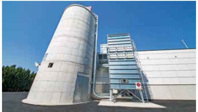
Die Sepas-Absauganlage von Scheuch Ligno an der neuen Produktionsstätte von Faustmann in der Nähe von Hartberg.
