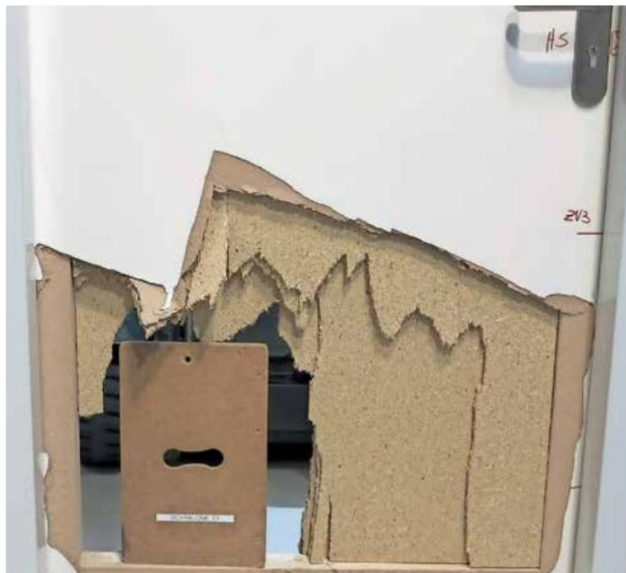
Durchgangsfähige Öffnung in Türblatt: Hier wurde mit dem Brecheisen gearbeitet.
