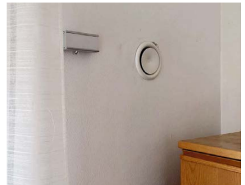
Im Innenraum ist nur der Teller der Einströmöffnung zu sehen – links daneben die Steuerung.
