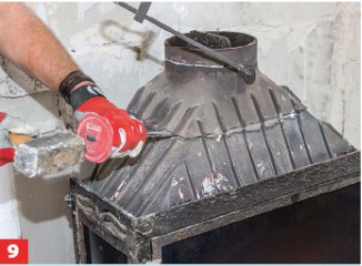
9 Inwieweit der Heizeinsatz für den Abtransport zerlegt werden kann, muss im Einzelfall geschaut werden.
