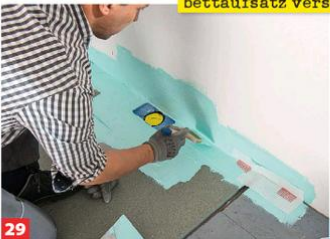
29 In die Eckbereiche zwischen Wand und Boden sowie dann auch über die Anschlussfugen zwischen Gefälleplatte und Estrich ...
