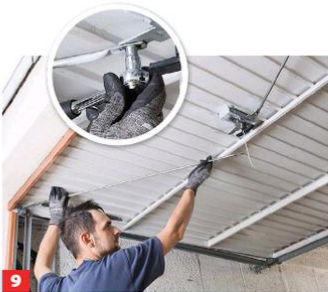
9 Je nach Garagentor müssen Bauteile demontiert werden, an diesem Schwingtor die zwei Verschlussstangen.
