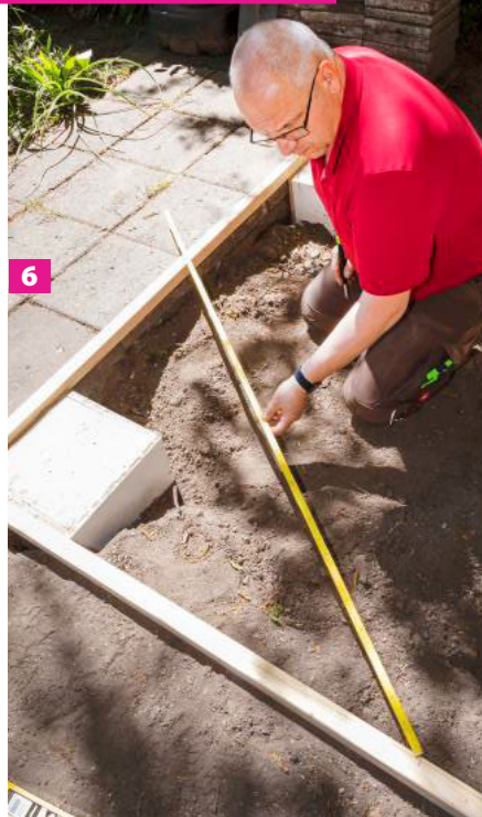
Die Fundamente müssen exakt auf einem Höhenniveau liegen!
