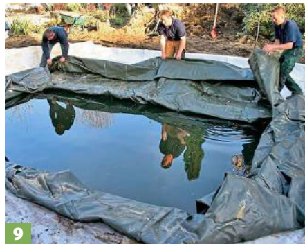
9 Nach und nach die Poolfolie darüber ausbreiten und glattziehen. Je nach Folientyp die Nähte verschweißen.
