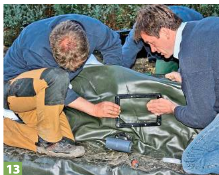
13 ... Skimmerklappe einbauen, über die dann das zu reinigende Oberflächenwasser in den Filter strömt.
