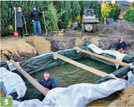
5 Dann kam die Poolfolie. Wände wie hier mit einer Verstrebung abstützen, nach und nach Wasser einfüllen ...
