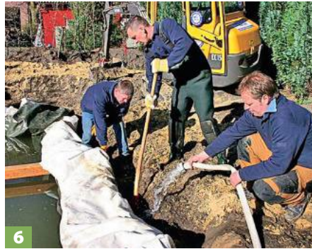
6 ... und die Folie glätten. Parallel dazu die Wände hinterfüllen. Die Erde ggf. einschlämmen und stets verdichten.
