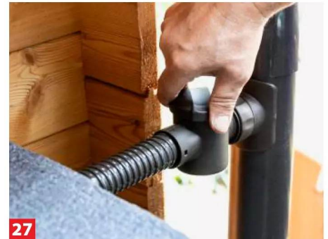
27 Das Rohr kann man mit einem Regenwasserbehälter verbinden, z. B. über Fallrohrfilter (Graf Regensammler Speedy).
