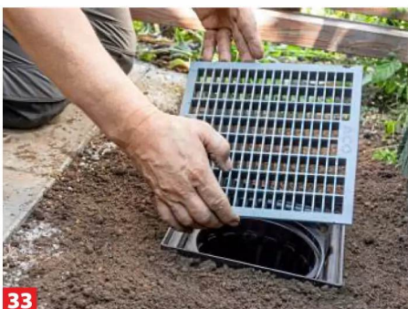
33 Der leicht abnehmbare Kunststoffrost hat eine Maschenweite (MW) von 30/103. Samt Schacht ist er begehbar.
