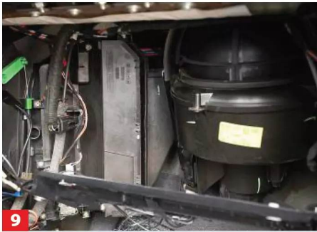
9 Nun ist die Klappe zum Filterkasten zugänglich – hier aufrecht stehend links neben dem runden Gehäuse des Ventilators.
