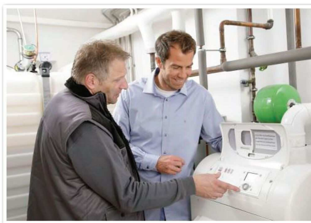
Foto: BV Lagerbehälter
