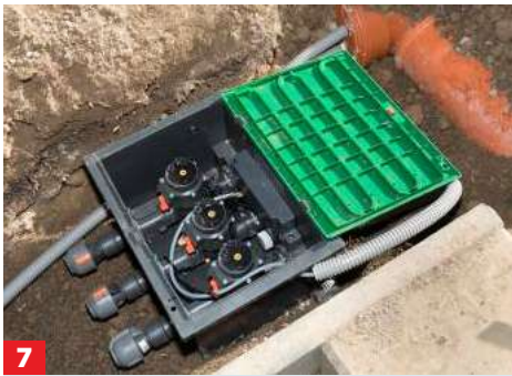
7 Hier ist die fertig angeschlossene Ventilbox zu sehen.
