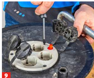
9 Schließlich die Verteilerplatte wieder montieren und das Verlängerungskabel aufrollen – fertig!
