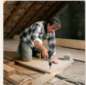
Selbst Dämmstreifen darunter sorgen kaum für Schallschutz.
