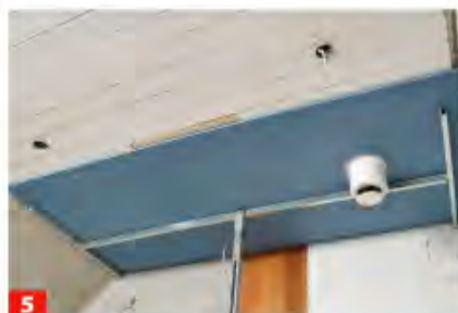
5 Unser Bauherr verkleidete die Decke nun mit Gipsplatten direkt auf der alten Holzpaneeldecke. Selbst wenn die Montage durch ...
