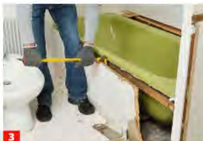
3 Selbst an der Badewanne hatte man vormals Holzplatten verbaut, die samt Lattung schon ziemlich marode waren.
