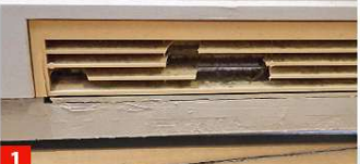
1 Kaputt: Richtung Bad lag das Türgitter unten auf Bodenhöhe. Bei dem alten, porösen Kunststoff reichte ein versehentlicher Tritt.
