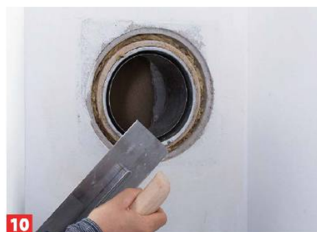
10 Abplatzungen und kleine Risse/Fugen rund um den Anschlussbereich verspachteln.
