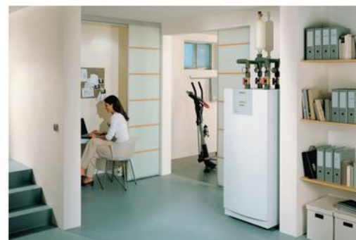
WÄRMEPUMPE: Kompakte Geräte können sogar im Wohnkeller aufgestellt werden.
