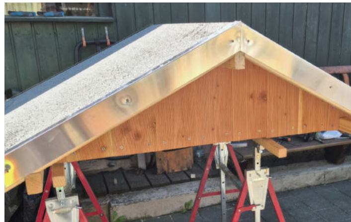
Mehrschichtig aufgebaut: OSB-Platte, Schweißbahn und Aluminiumblech schützen den Schrank dauerhaft vor Regen .
