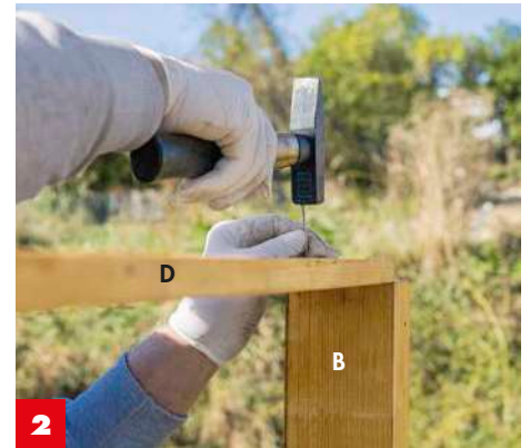
2 Die horizontalen Streben (D) werden einfach auf die Pfosten genagelt. An der Ecke erhalten sie eine Gehung von 45 Grad ...
