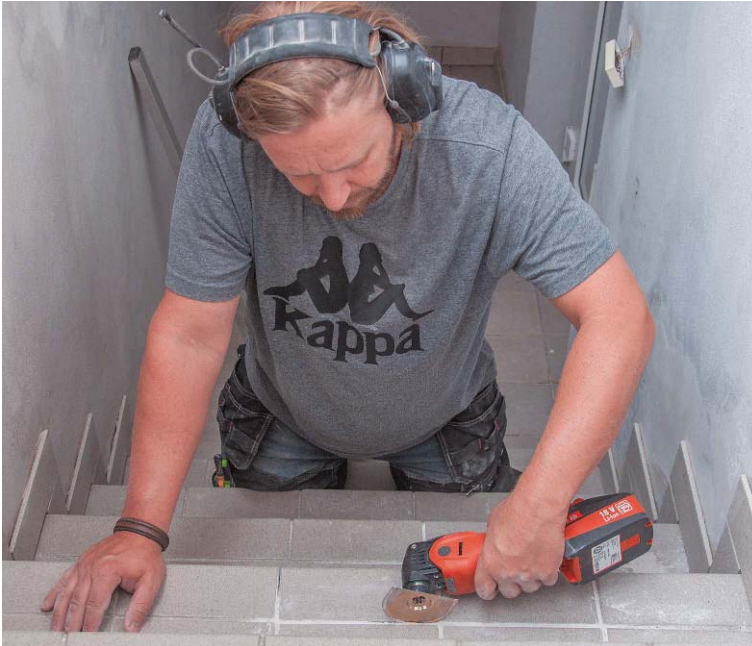
Bei defekte Fugen hilft kein Nachbessern: Die Fugen müssen komplett neu gemacht werden. Dazu die alte Fuge mit einem Multitool ausfräsen und anschließend neu verfugen
