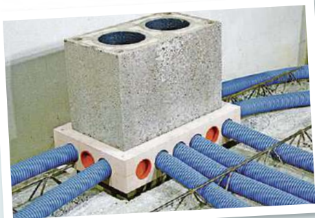
Die Flexrohre führen vom Lüftungsstein weg und versorgen die Räume mit Luft
