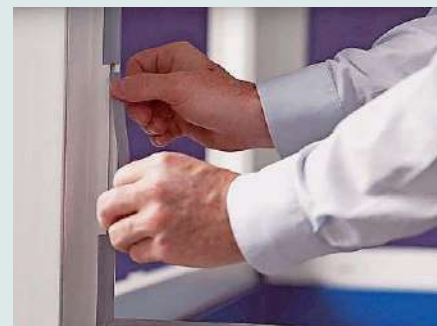
Teile der Fensterdichtung müssen herausgeschnitten und ausgetauscht werden
