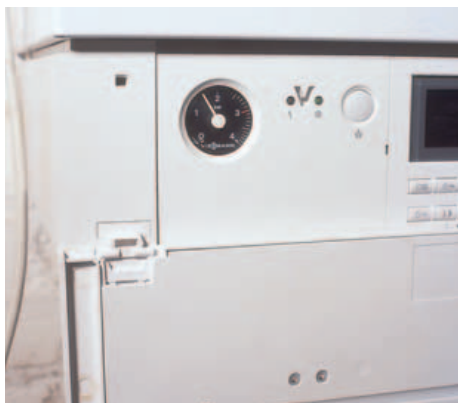
18 Am Kesselmanometer lesen Sie den Wasserdruck ab. Wasser wird so lange aufgefüllt, bis der ursprüngliche Druck wieder erreicht ist.
