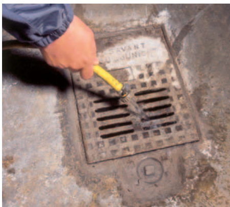
4 KFE-Hahn vorsichtig öffnen und das Wasser in den Bodenablauf des Kellers oder in ein geeignetes Gefäß ablaufen lassen.
