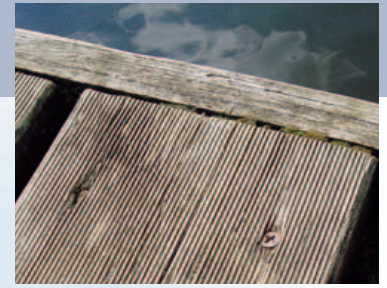
Zu tief versenkte Schrauben in Außendecks lassen druckimprägniertes Holz schnell Feuchtigkeit ziehen.
