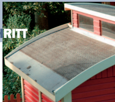
1 Eine einfache Lage gesandete Bitumenbahn musste bisher das Dach vor Wind und Wetter schützen. Zu wenig für dauerhaften Schutz.
