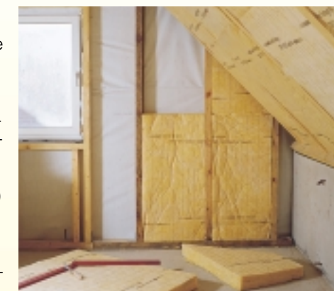
Vor dem Dämmen der Giebelwände fragen Sie einen Architekten, ob dies eine Taupunktverlagerung und so Folgeschäden bewirken kann.
