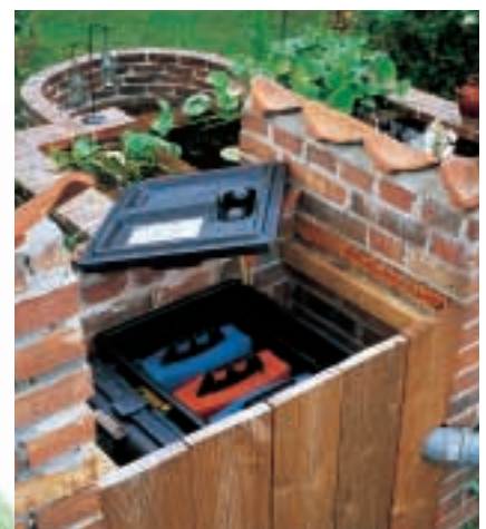
Die Filteranlage muss jederzeit zugänglich sein, um die Filter reinigen zu können. Ein Holzverschlag mit abnehmbarem Deckel reicht als Behausung aus. Setzen Sie den Filter mindestens auf Wasserspiegelhöhe.
