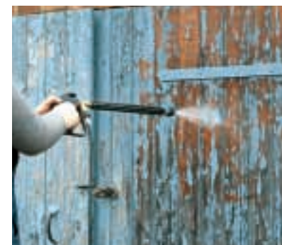
Anstriche im Außenbereich, die zum Teil abgeblättert sind, können mit dem Hoch-druckreiniger vollständig entfernt werden. Vor dem Neuanstrich gut trocknen lassen.
