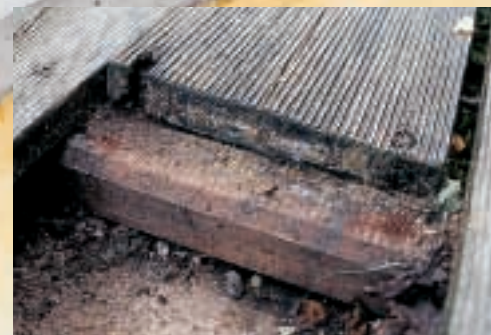
Ausgerissene Schraubenlöcher. Schrauben aus dem falschen Material, zu nah am Rand und zu tief eingedreht, sind verantwortlich für dieses Schadensbild.
