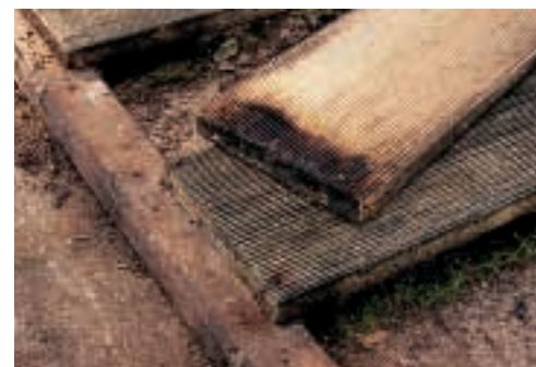
Faultes Holz an den Kanten der Bretter. Hier fehlte seit dem Zuschnitt die Imprägnierung. Eine nachträglich aufgetragene Lasur hätte das Holz schützen können.
