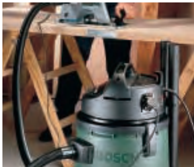
Beim Sägen und Hobeln fallen grobe Späne an. Entsprechend groß muss der Durchmesser des Saugschlauchs sein, sonst kommt es zu Verstopfungen.
