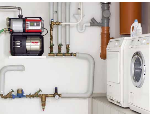
Hier sieht man ein eingebautes Hauswasserwerk, der technische Aufwand ist gering, dafür müssen Brauch- und Trinkwasser im Haus getrennt werden
