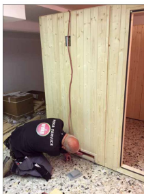
5 Achtung auch, was das Innenleben der Vorderwand angeht. An der wird nämlich innen der Ofen angebracht und durch die Röhren in der Wand und den Lüftungsschlitzen unten mit den später auf dem Saunadach liegenden Modulen verbunden.
