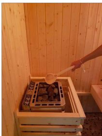
13 Der Elektriker hat laut Schaltplan alles angeschlossen inklusive Saunaleuchte. Jetzt heißt es Stress und Klamotten abzustreifen, das Saunatuch bereitzulegen und einen schönen Aufguss vorzubereiten.
