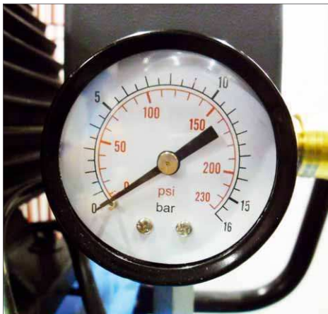
Dieses Manometer gibt den Kesseldruck in bar und psi an
