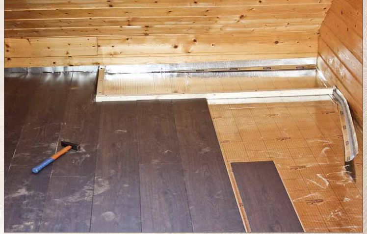
14 Das Heizkörper-„Podest“ wird vom Boden komplett eingefasst
