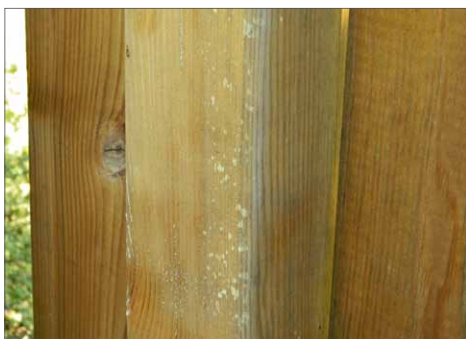
4 An vielen Stellen geht sogar der Bläueschutz verloren
