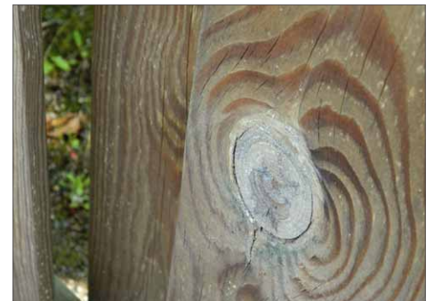
3 Das Holz ist offen und bietet Wasser, Fäule und Schädlingen keinen Widerstand mehr
