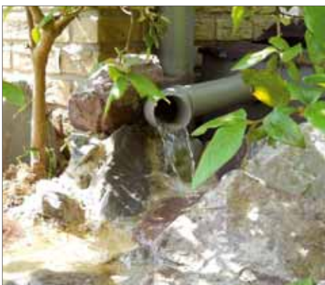
Ums Hauseck versteckt ist die Filteranlage mit dem satten Wasserzulauf
