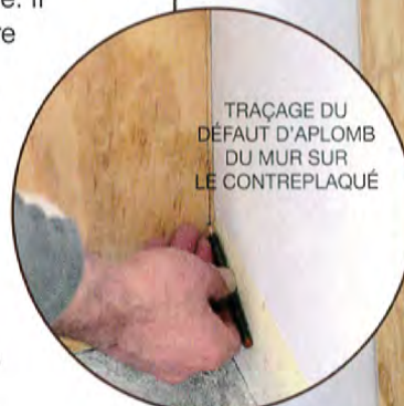
Le premier côté prêt à être ajusté. Notez les défauts bien visibles.
