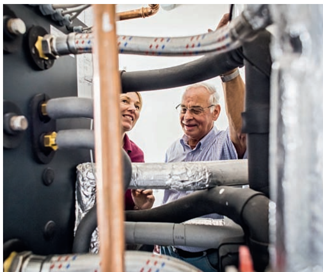
Bauherrenberater Dipl.-Ing. Reiner Uelze überprüft mit Bauherrin Bettina Wusowski Heizungsanlage und Rohrleitungen.
